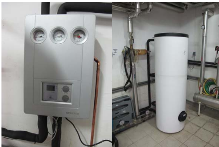
Slika 4 Ostale komponente nužne za funkcioniranje solarnog sustava (cirkulacijske pumpe i automatska regulacija- desno; akumulacijski spremnik – lijevo)
